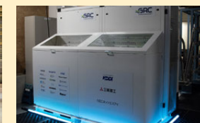
液浸冷却装置 (室内)
