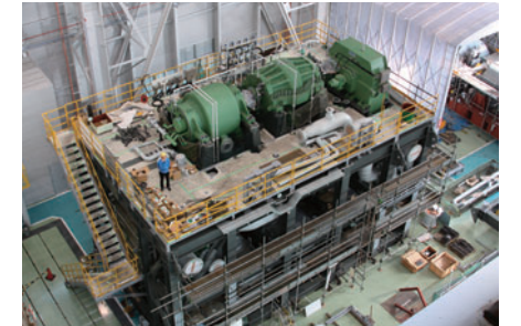
超大型コンプレッサ・モジュール
