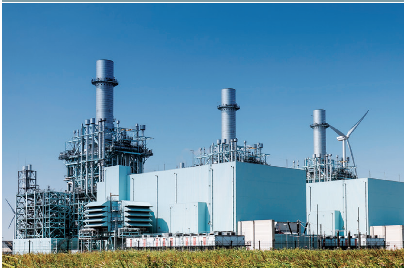
オランダMAGNUM発電所 (世界最大規模の大型ガスタービン発電設備の水素焚き転換プロジェクト)
