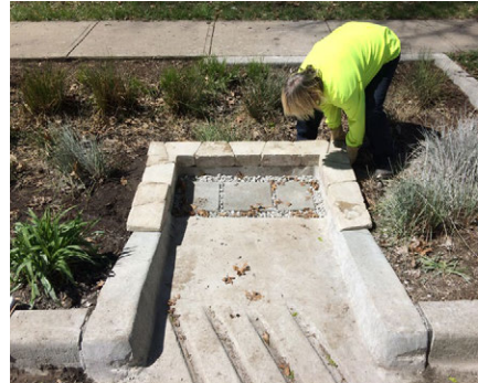
Concrete Forebay (Kansas City Water)
