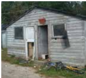
Ninguna puerta con tela metálica
