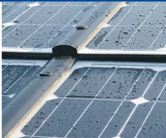
Fig. 1 - Detail of BIPV monocrystalline modules in the 5 kWp PV plant in Verona (Photo: GSE Gestore dei Servizi Energetici - www.gse.it ).
