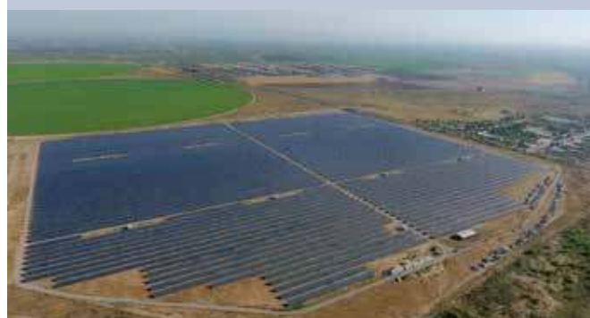
Fig. 2 - Parque Solar Coahuila in Matamoros, Coahuila, Mexico; 22,7 MW (Photo: https://www.elsiglodetorreon.com.mx/noticia/fotos.php?nota=1441166 ).
