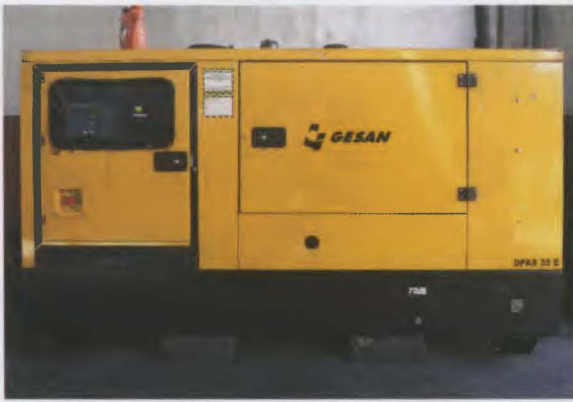
Photo 2 : Groupe électrogène gasoil, commune Manerinerina.
