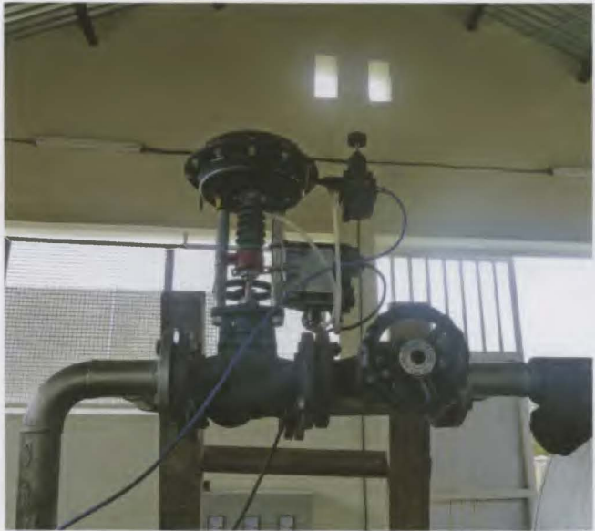
Photo 7 : Vanne solénoïde proportionnelle contrôlant automatiquement l'admission de vapeur dans le moteur.
