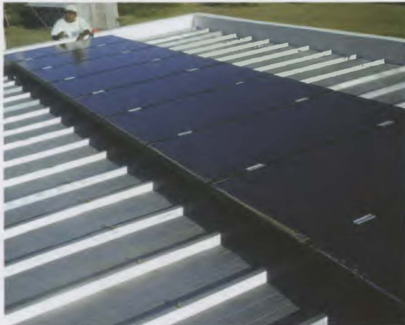
Photo 4 : Panneaux solaires, Ivovona, commune Ramena, région DIANA.
