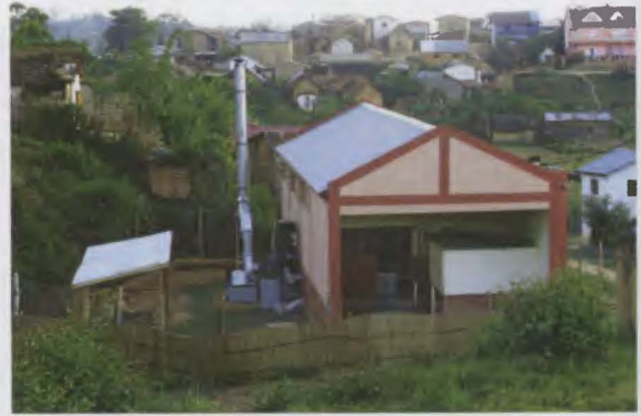
Photo 3 : Centrale biomasse-vapeur, commune Didy.
