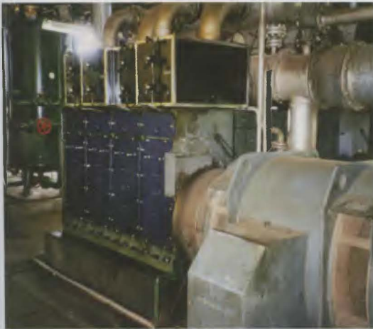
Photo 1 : Moteur à vapeur Spilling - 600 kW en RCA.
