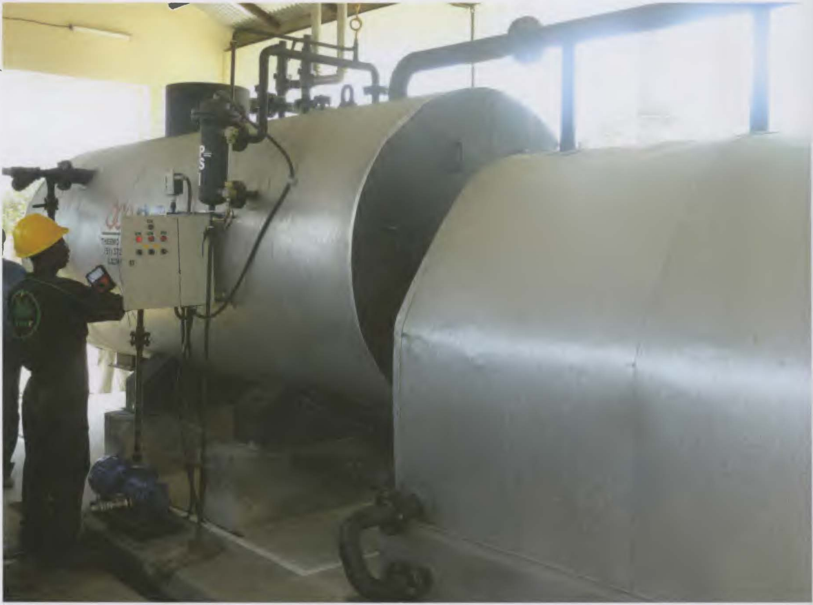
Photo 6 : Foyer et chaudière en phase d'installation sur le site de la commune rurale d'Andaingo en août 2012.
