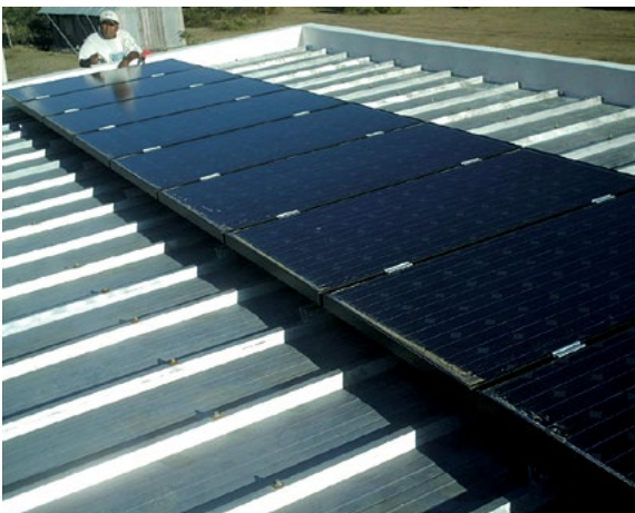
Photo 4 : Panneaux solaires, Ivovona, commune Ramena, région DIANA.
