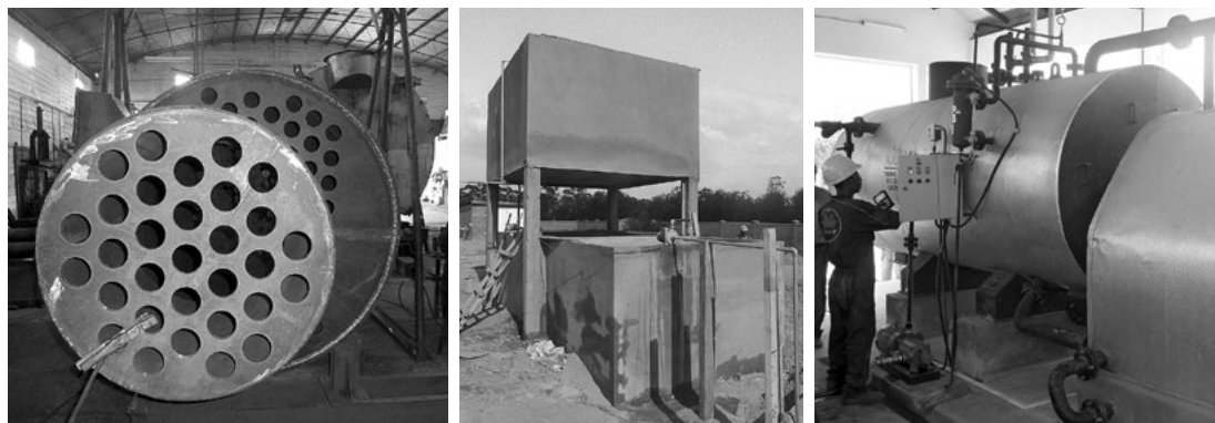
Photos 4 : Chaudière en construction avec détail des tubes de fumée. Traitement de l'eau d'alimentation et chaudière en opération sur le site d'Andaingo (Source : P. Pousset, 2012)
