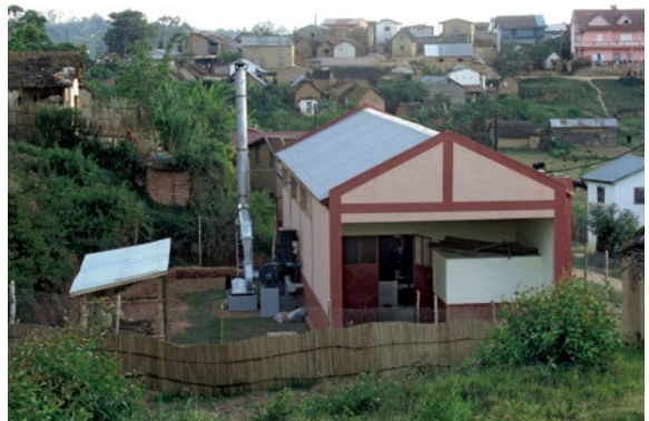
Photo 3 : Centrale biomasse-vapeur, commune Didy.
