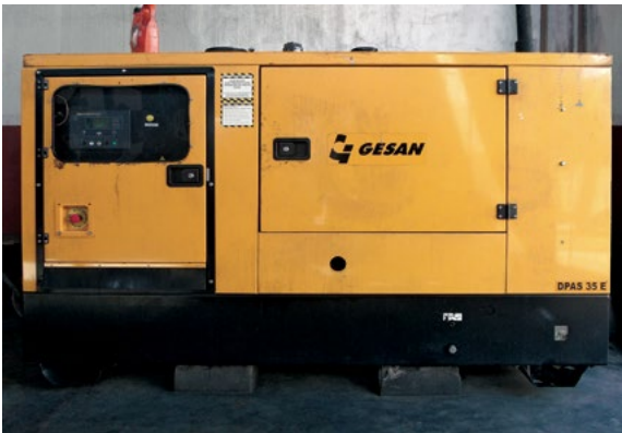
Photo 2 : Groupe électrogène gasoil, commune Manerinerina.
