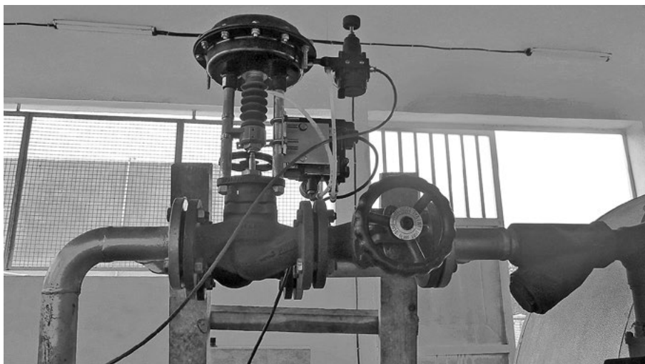
Photo 5 : Vanne solénoïde proportionnelle contrôlant automatiquement l'admission de vapeur dans le moteur (Source : P. Rousset, 2012)
