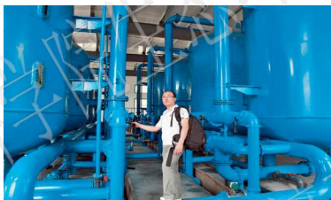
我国第一座大型除砷水厂 (北京市, 5000m 3 /d)
