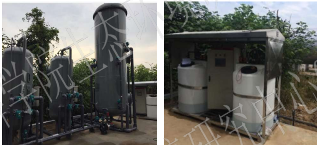
河南省兰考县农村饮用水除氟工程（240 m 3 /d）
