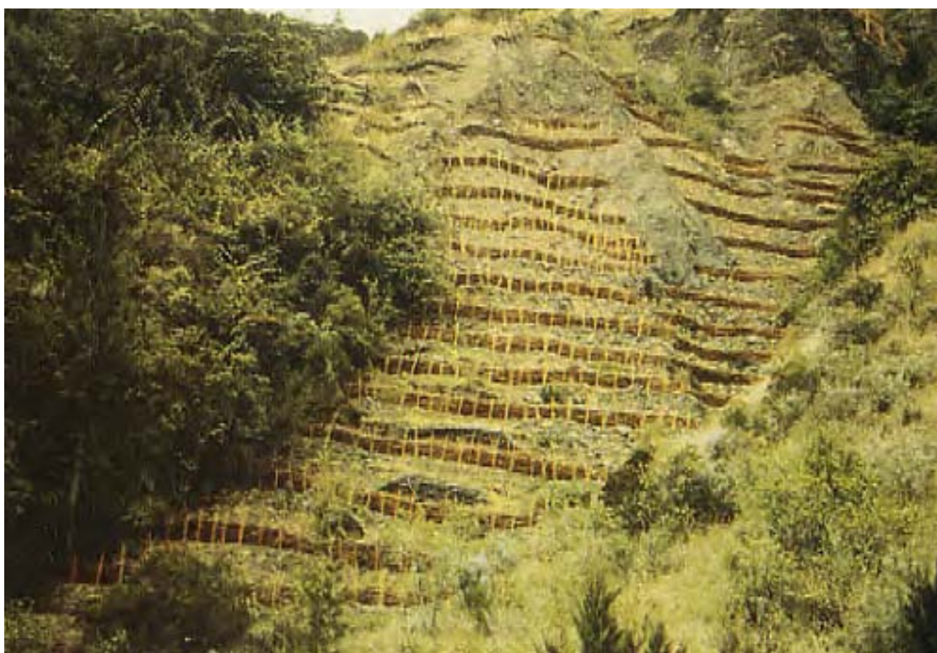
FIG. A.61 – photo 61 : Cirque de Salazie, près de Grand-Ilet : Travaux de RTM, réalisés par l'ONF. Essai de stabilisation des ravinements par construction de fascines et reboisement.
