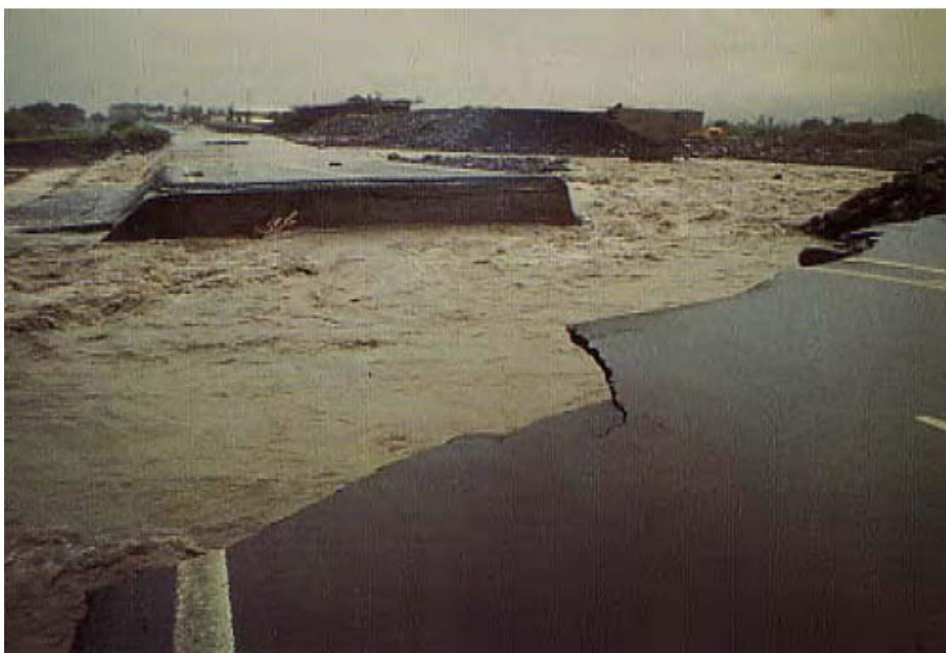
FIG. A.55 – photo 55 : Nord de l'île - Rivière des Pluies : radier emporté par la crue lors du cyclone Hyacinthe (janvier 1980).
