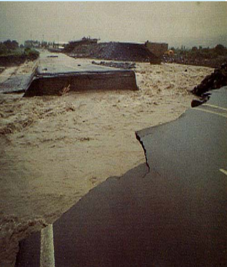
Nord de l'île : radier emporté par la crue lors du cyclone Hyacinthe en janvier 1980 (photo M. Raunet)
